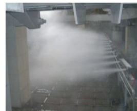
汽车卸料口抑尘
